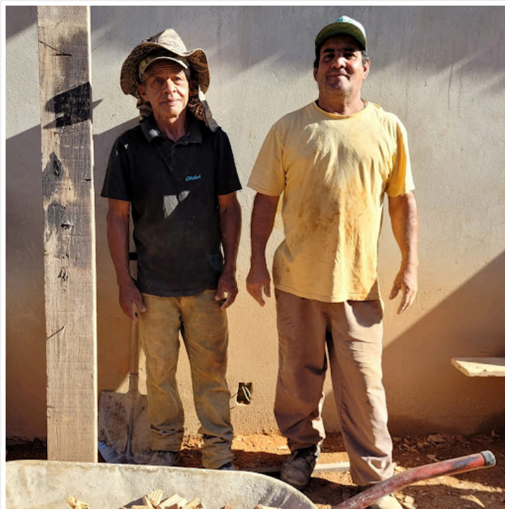
Após aposentado, Airton passou a trabalhar como pedreiro, com o seu colaborador Val – Genivaldo. Tiradentes-MG. Fotografia: Luiz Cruz.
